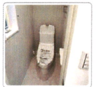
温水洗浄便座付きトイレ
